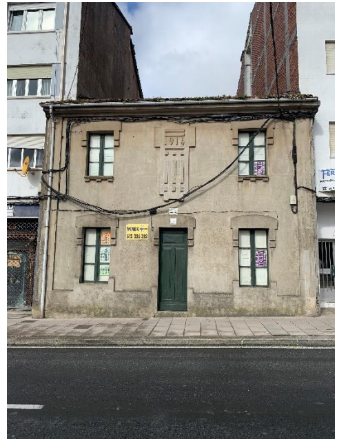
Ilustración 21: Cableado colgante II
