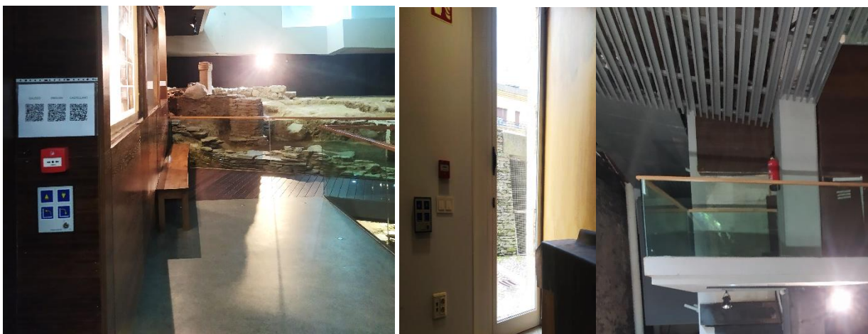
Fig. 36 e 37. Imaxes con dispositivos de emerxencia (alarmas, sinalización de extintores de incendios).
