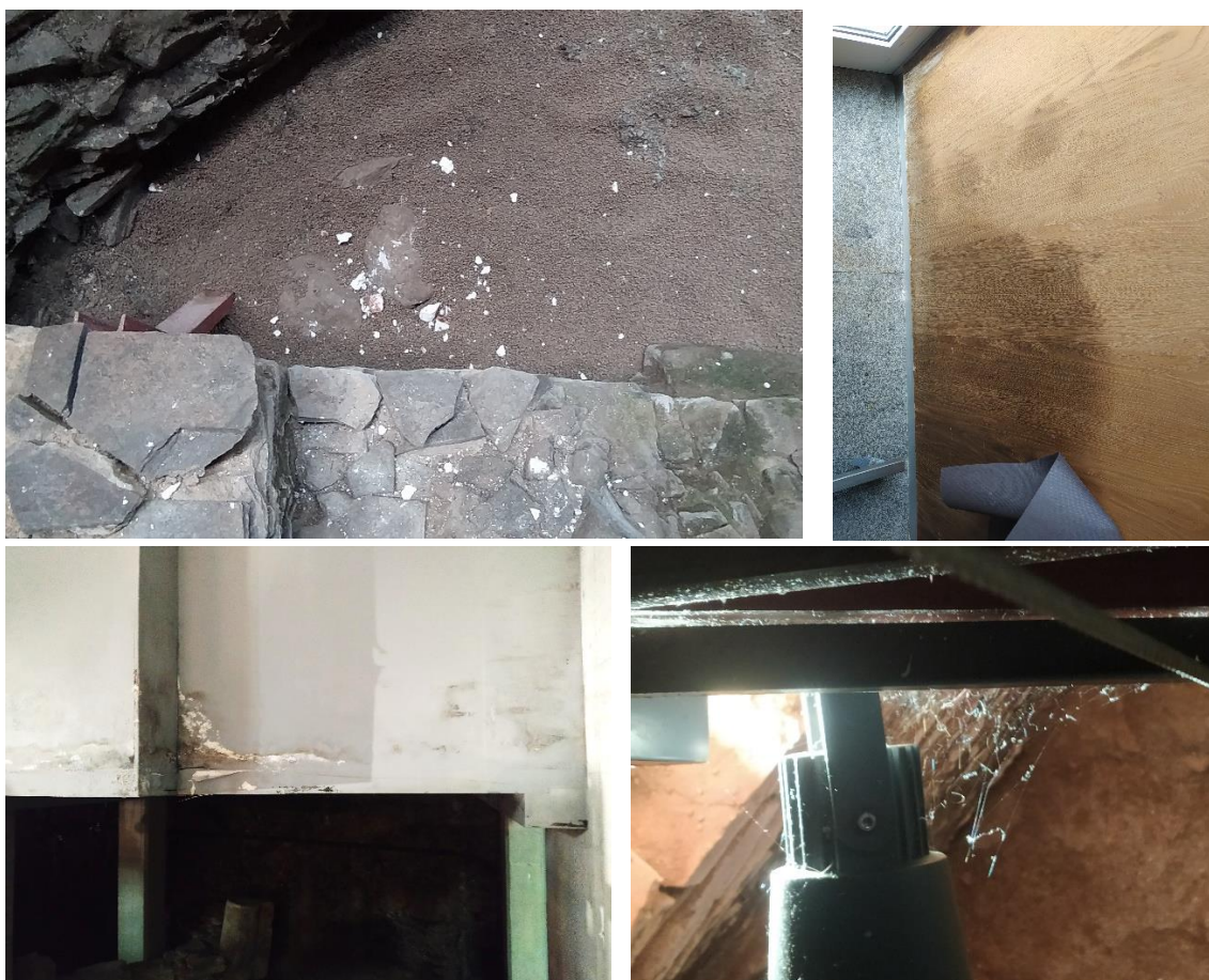
Fig. 43, 44, 45 e 46. Fotografías de detalle dos riscos identificados na Domus: desprendementos do material que recubre o falso teito, humidades, desperfetos na parede, sucidade acumulada, arañeiras.
