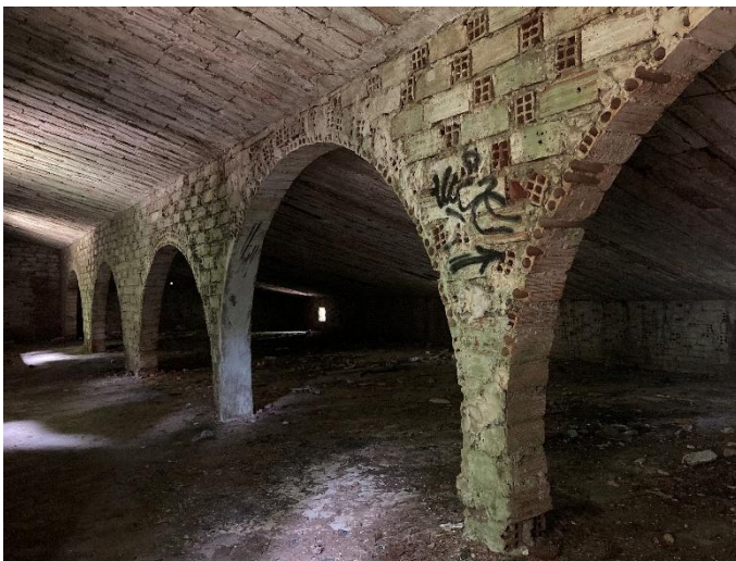
Fig. 18. Interior de las instalaciones de la Batería J-3, en el que se aprecia un estado ruinoso. Fuente: autoría propia.
