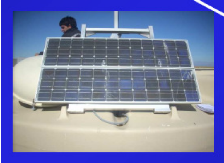
Figura 3.10. Muestra de módulos fotovoltaicos con diversas anomalías.
