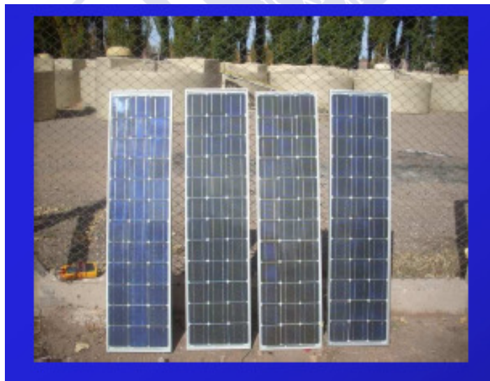
Figura 3.13. Los cuatro módulos fotovoltaicos estudiados en el edificio de ensamble del Observatorio.
