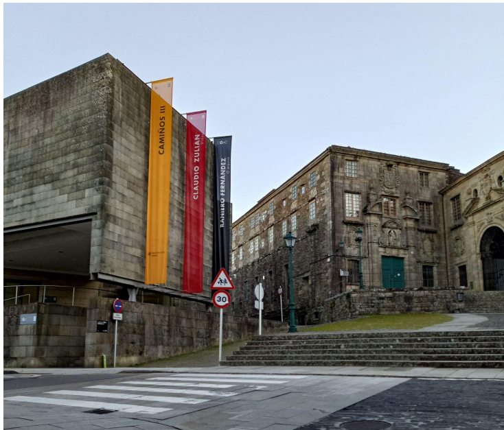
Fig. 36. Fachada del CGAC. Granito deteriorado con “negros chorretones”. Imagen de la autora.
