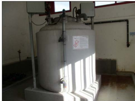
Figura 16. Dosificación de cloruro férrico.
