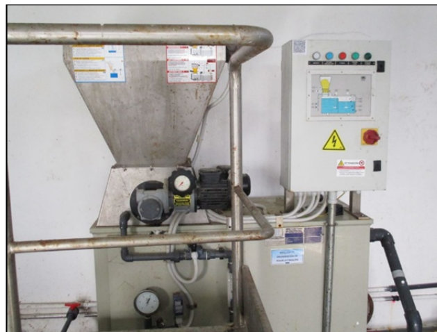
Figura 20. Máquina de preparación y dosificación de polielectrolito.
