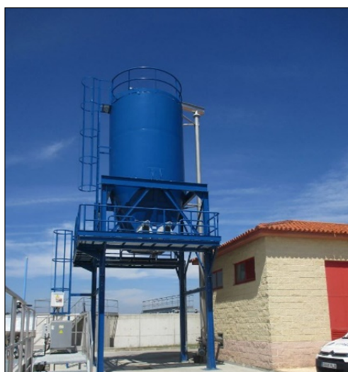
Figura 22. Silo de fangos.
