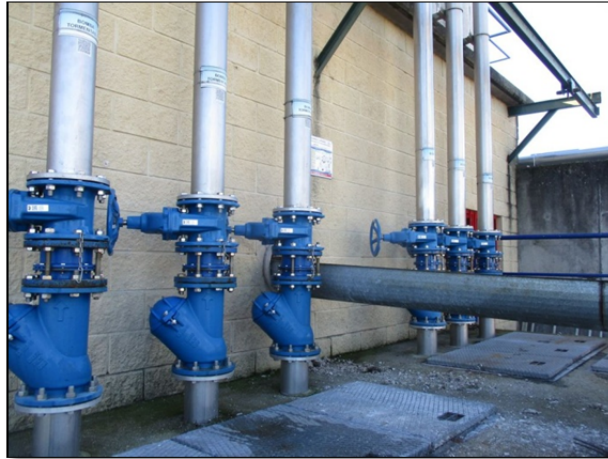
Figura 11. Bombas instaladas en el bombeo de cabecera.
