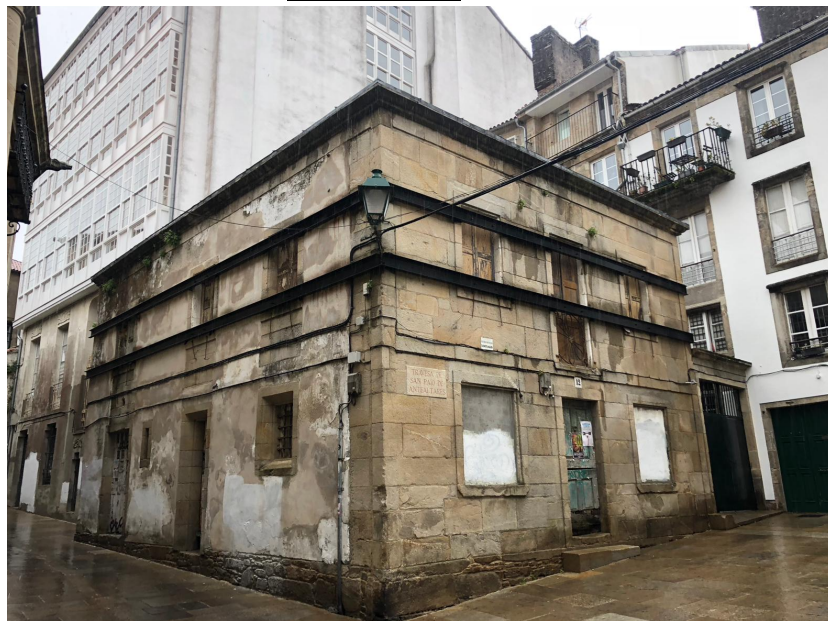
Edificio apuntalado por riesgo de derrumbe en la Travesía de San Paio de Antealtares. (Fotografía del 24/04/2019)
