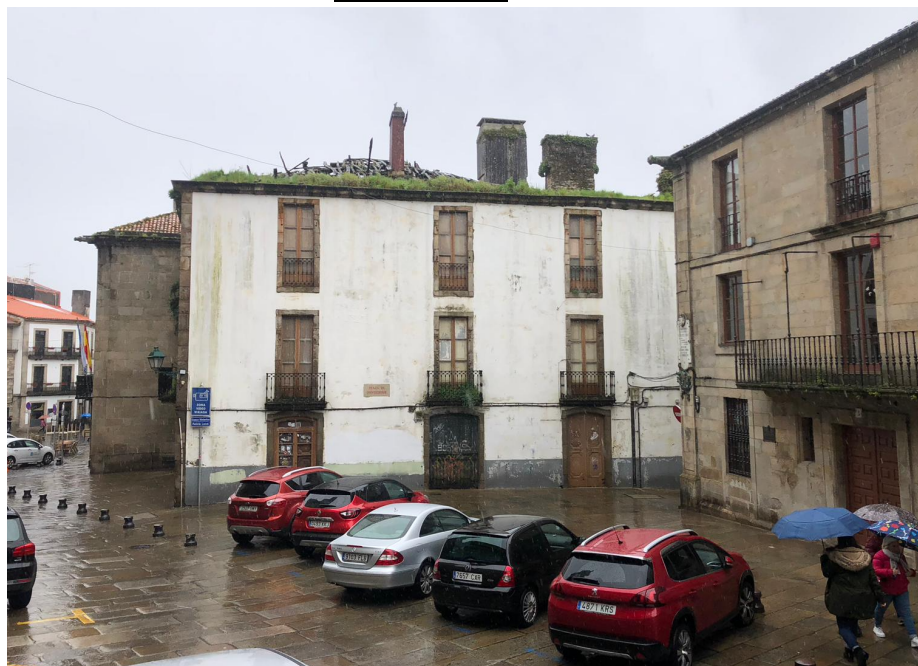
Edificio abandonado con tejado derruido en la Praza da Universidade. (Fotografía del 24/04/2019)
