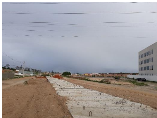
Trecho da drenagem canalizado
