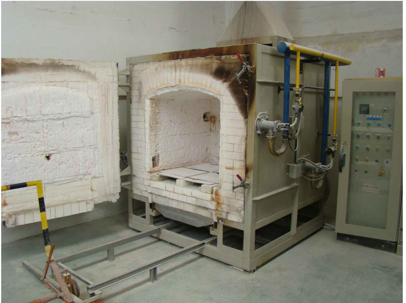
Foto 1 Horno a gas con control automático y arranque automático en caso de parada
