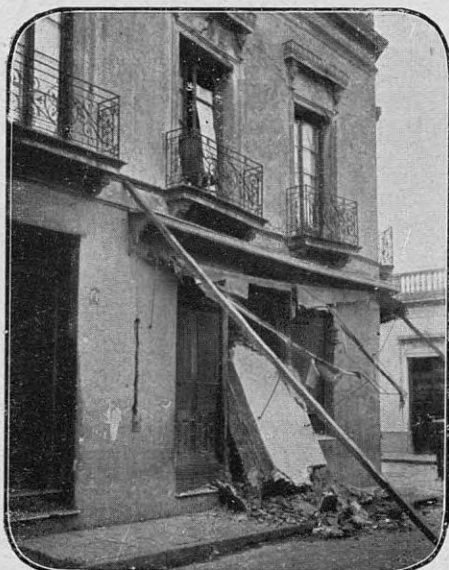
Casa derrumbada en la calle Tacuarí y Chile
