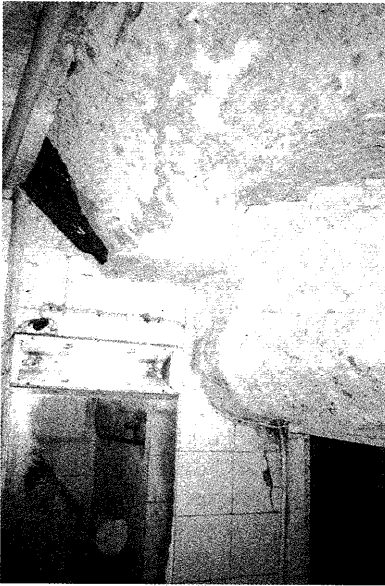
Rehabilitación interior de una vivienda: estado inicial.
