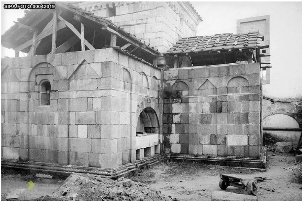
Fig. 33. Cubertas contemporáneas de São Frutuoso de Montélios durante as labores de reconstrucción. Fonte: SIPA ( ligazón )
