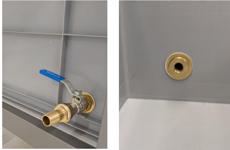
Figura 17. Conexión de desagüe en el depósito de agua; izquierda: vista exterior; derecha: vista interior.
