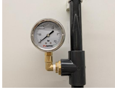
Figura 14. Manómetro del tramo vertical entre líneas 3 y 4, lado derecho.
