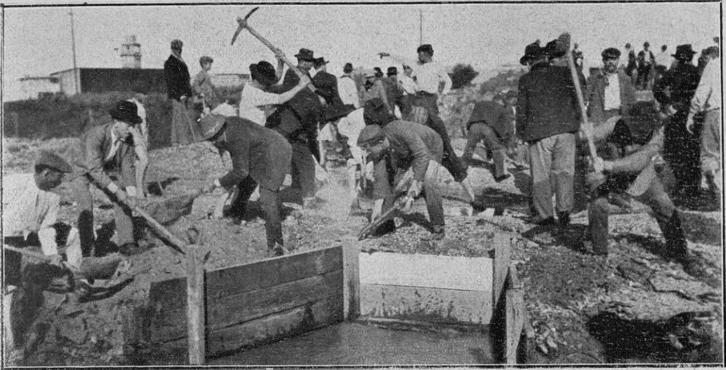
Vecinos de Nueva Pompeya atacando con picos y palas las alcantarillas del Trocha Angosta, para dar desagüe al barrio
