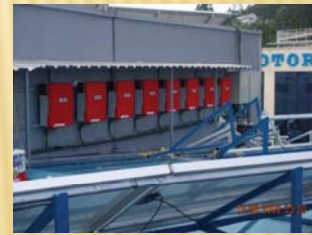
Instalación fotovoltaica de conex. a red 50kw en BT Pontevedra
