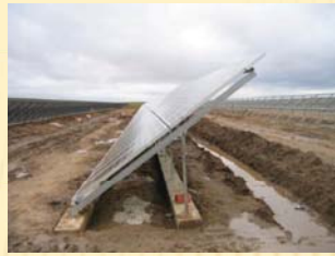
Instalación fotovoltaica de conexión a red 550kw en MT
