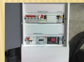
Cuadro de control piscina
