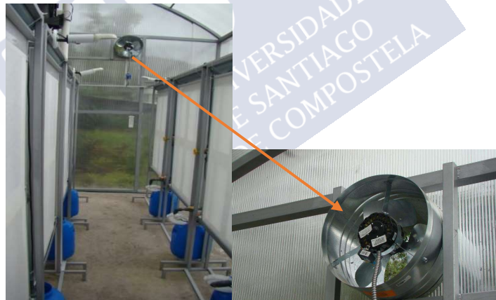
Figura 3. Vista de uno de los cuatro ventiladores instalados en el invernadero
