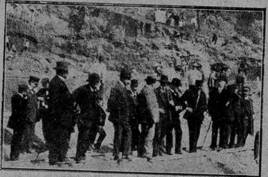
El ministro de fomento visitando las importantes obras del pantano de Guadalmeiyato
