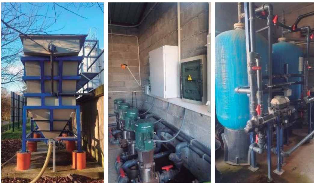
Figura 48. Sistema de depuración de los núcleos avícolas Altapedra y Cortegada
