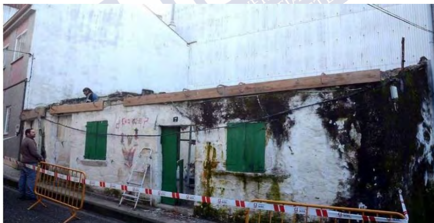
Figura 37. Restos de casa marinera en la calle Fonte da Moureira, arrabal de la Moureira. Rafa Vázquez, 2016. Recuperado de Faro de Vigo: https://www.farodevigo.es/pontevedra/2016/02/26/moureira-desaparece-16686215.html
