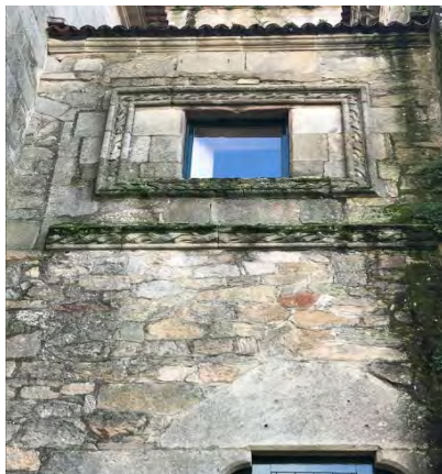
Figura 8. Ventana del Pazo de los Churruchaos en la fachada principal de la iglesia de san Francisco, 2020. (Belén Álvarez Pérez).
