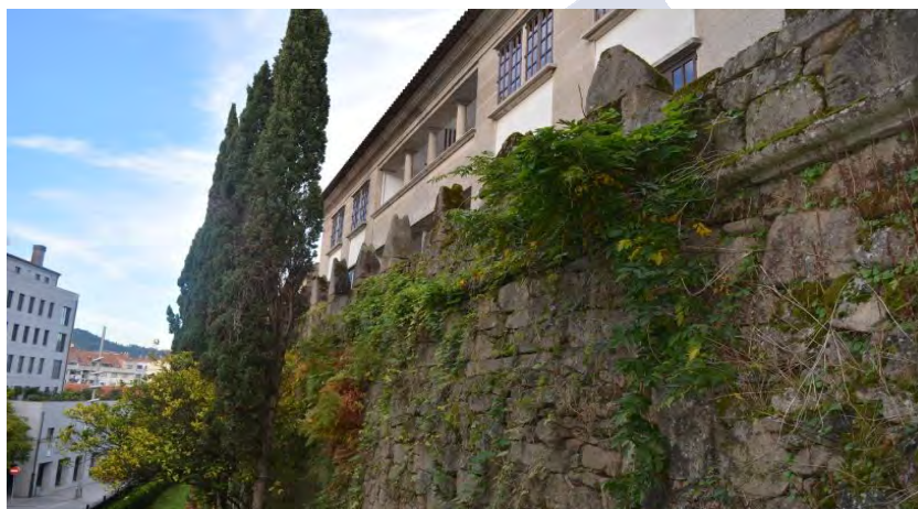
Figura 59. Lienzo exterior de la muralla de Pontevedra, calle Arzobispo Malvar. Belén Álvarez Pérez, 2019.
