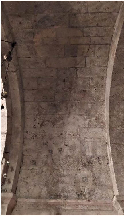
Fig. 76: Parte norte do primeiro tramo da bóveda do presbiterio de Santa María de Camporramiro.
