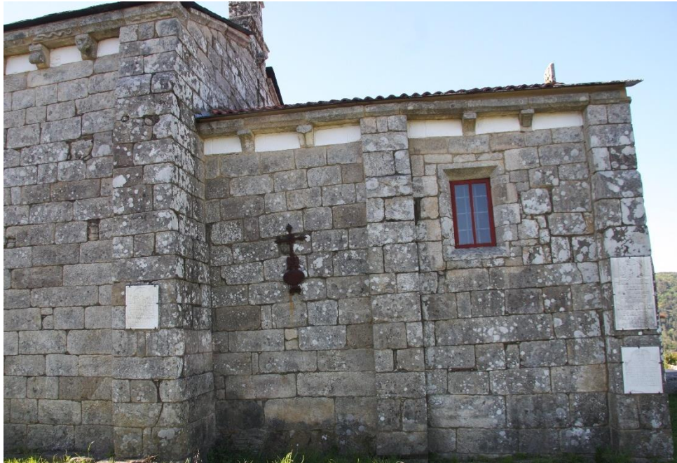
Fig. 5: Muros sur da nave a da cabeceira de Nogueira. Detalle da prolongación dos muros dos testeiros da nave e da cabeceira, facendo a función de contrafortes.
