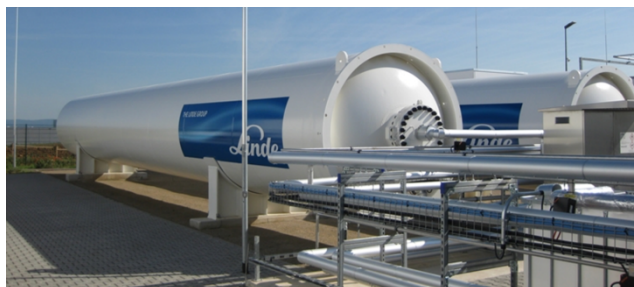
Figura 51. Tanque de almacenamiento de hidrógeno a alta presión.
