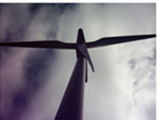
10. Un generador eólico
