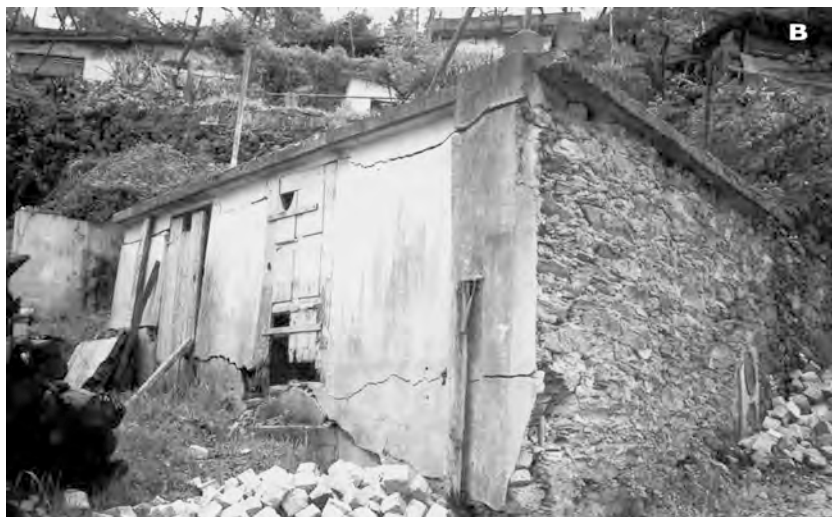
Figura 7 - Foto panorâmica evidenciando o risco de queda de blocos na vertente norte da escarpa de falha de S. Domingos (Chaminé et al. , 2004) [A] e manifestação da subsidência mineira em edifícios na área próxima à antiga mina de carvão de Germunde (Chaminé, 1992) [B].
