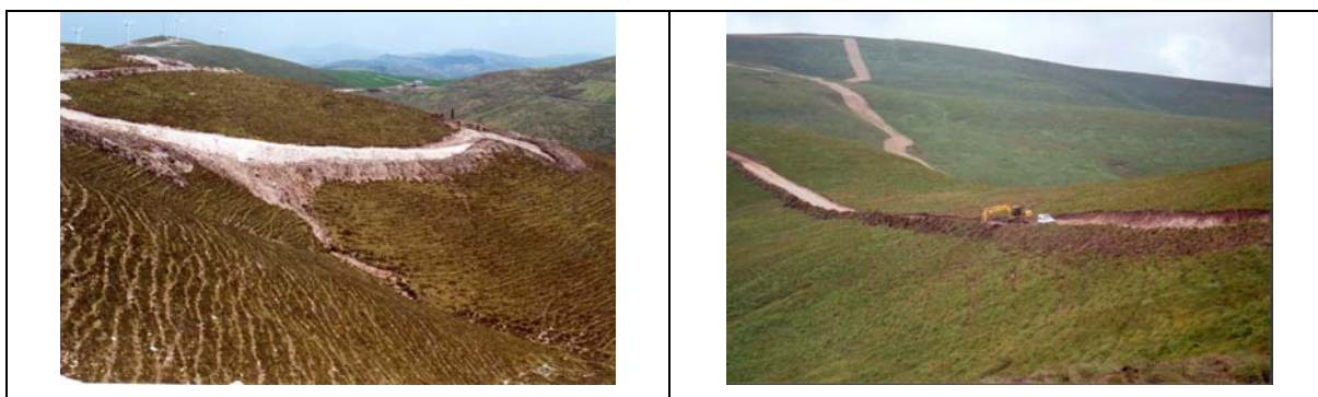
Figura V.5. Las condiciones de estabilidad de los terraplenes determinan la aparición de episodios erosivos y la posibilidad de ocurrencia de afecciones a la vegetación y a los cursos de agua existentes ladera abajo.
