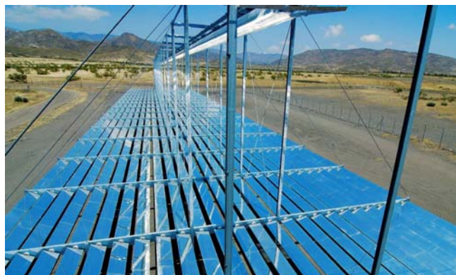
Figura 7. Fresdemo, situado en la Planta Solar de Almería.
