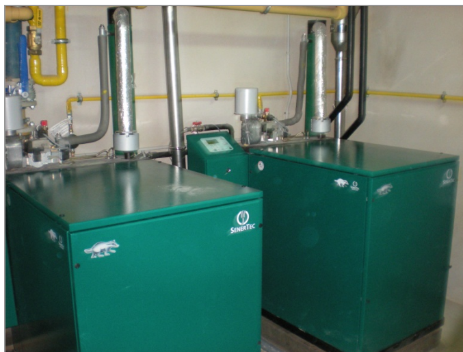
Figura 9. Detalle de los equipos.
