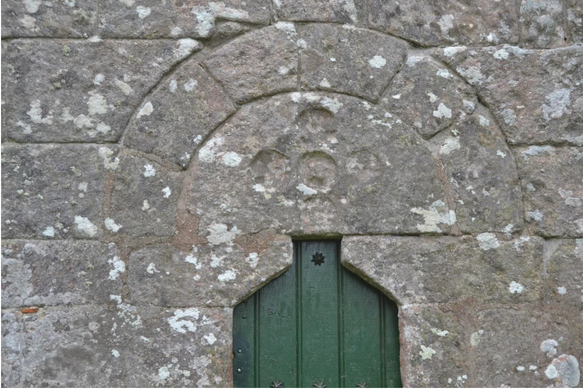
Figura 13. Tímpano semicircular que presenta cruz griega conformada por cinco círculos y estrellas labrados en bajorrelieve. Muro septentrional de san Miguel de Breamo (2020).
