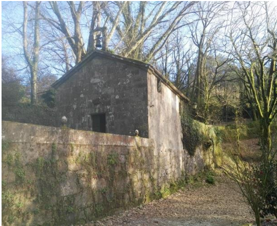
Figura 36. Muro lateral de la capilla. Foto: la autora.
