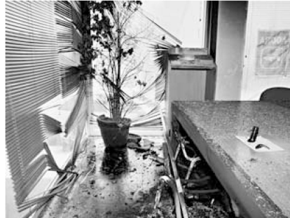
Detalle de los daños causados en la sede del PP en Nigrán por un cóctel molotov | JUAN CARLOS GAL
